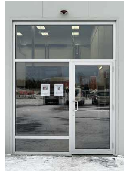
Un esempio di installazione in cui il MultiSensor della Senstar monitora una entrata pubblica.
